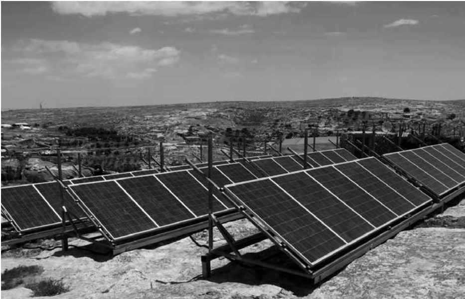
Von Comet-ME erstellte Fotovoltaikanlage im Dorf Shaeb El Buttum im Süd-Hebron
