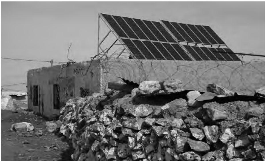
Dank Solarpanels auf dem Dach gibt es nun Licht im dunklen Inneren
